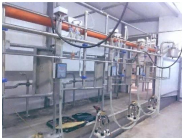
Оборудование для контроля за физическим состоянием животных в доильном зале
